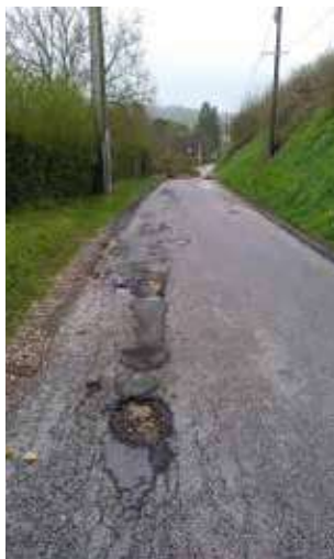
Ici la rue des Gruchets à Saint Denis le Ferment. Des études de réfection de voirie et de confortement de talus ont débuté en 2018 suite aux intempéries de janvier et avril 2018. Sur cette commune, ces intempéries ont été déclarées en catastrophe naturelle.
